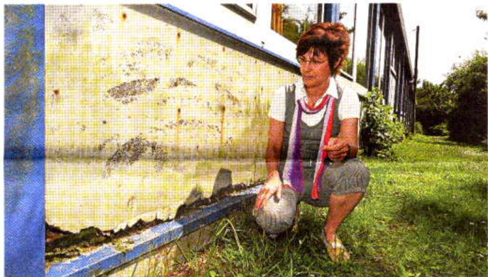
An der Rückseite der Pavillons sind die Außenverkleidungen völlig verrottet. Ingeborg Northhoff sucht dringend nach einer neuen Unterkunft für das Jugendorchester. Foto: ar
